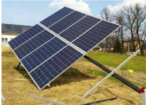
AW Projekt Sp z o.o., Adriana Waszak, Bielsko-Biala, Polen Photovoltaik Photo voltaics
